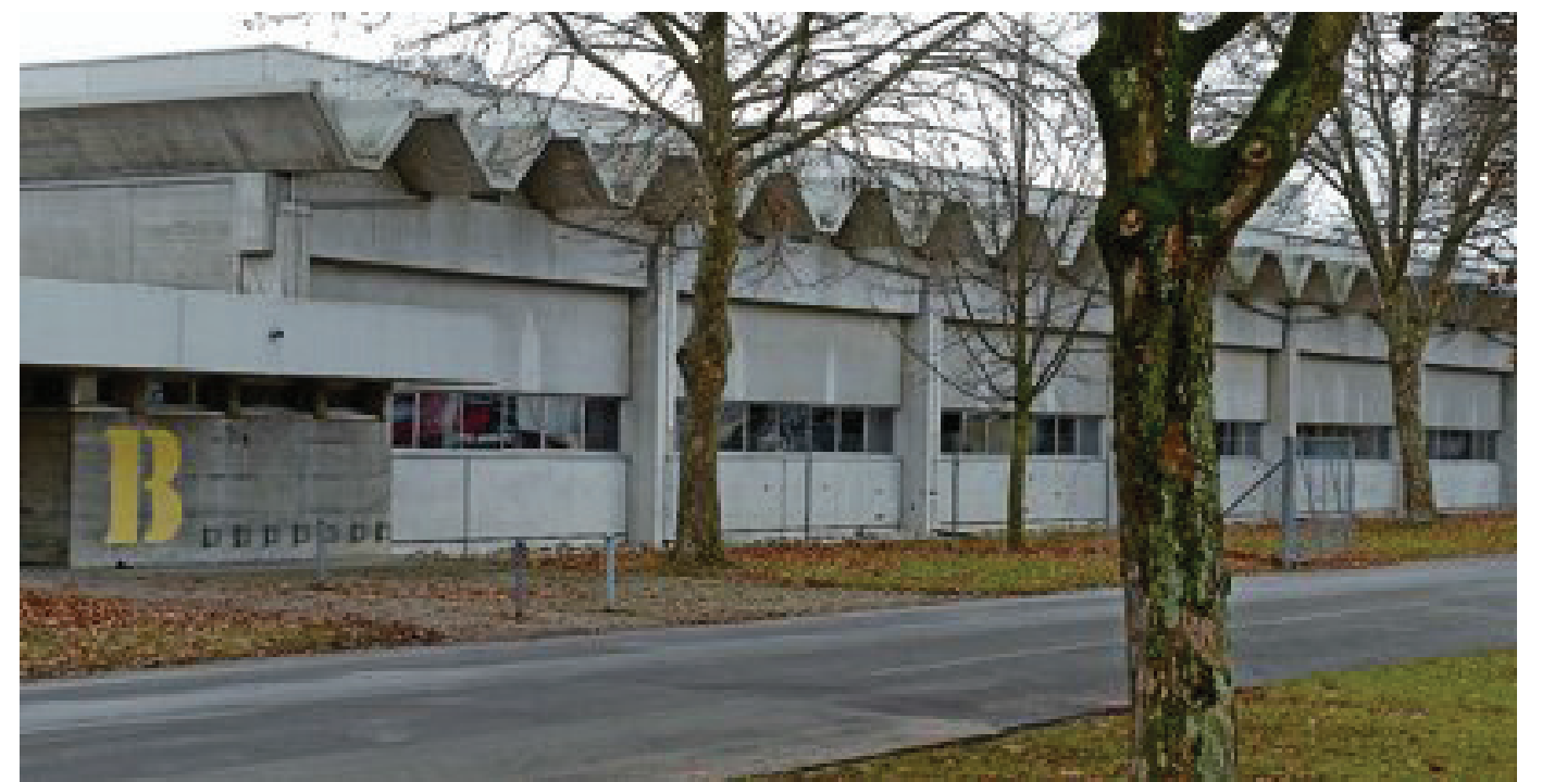
In den Panzerhallen A und B auf dem Waffenplatz Thun möchte das Staatssekretariat für Migration ein temporäres Bundesasylzentrum eröffnen.
